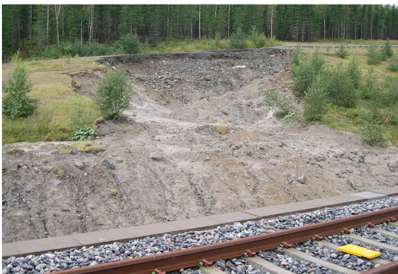
Figur 14. Skredet i den avbanade siltslätten vid Kornsjö tog med sig servicevägen hitom skogsridån på en sträcka av ca 40 m. Skredmassorna slog nästan över Botniabanan innan de slog tillbaka i diket. Foto: Johan Norrlin.
