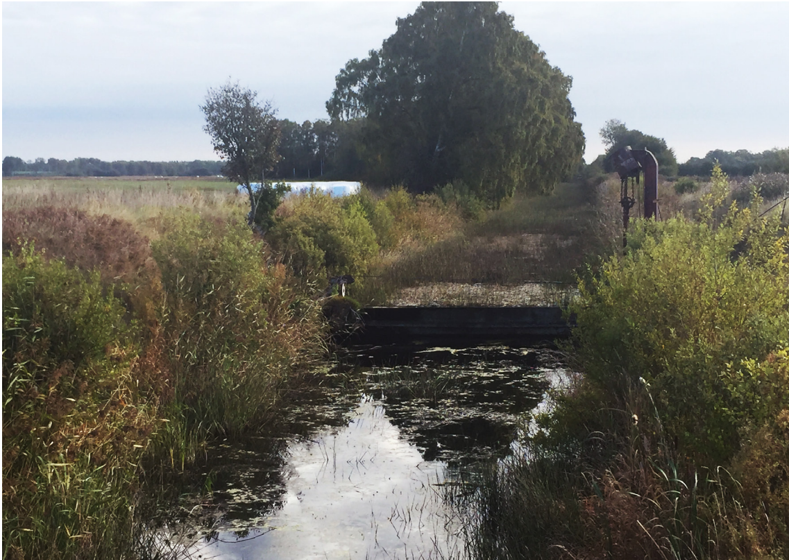
Figur 7. Dämt dike i Snodderåns dikningsföretag vid Mästermyr. Dämningen fungerar även som erosionskydd då trycket från vattnet hindrar ras från dikessidorna. Foto: Peter Dahlqvist.
