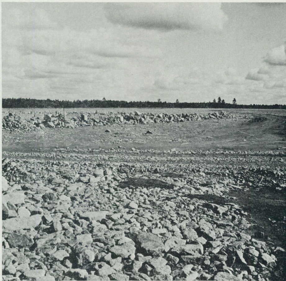
Fig. 16. Lillesjöområdet (5f) har utjämnats genom sprängning av de högst belägna partierna och fyllning med sprängsten av lägre liggande områden. Innan nivelleringen började hade all jord schaktats bort. Foto förf. 1971.
