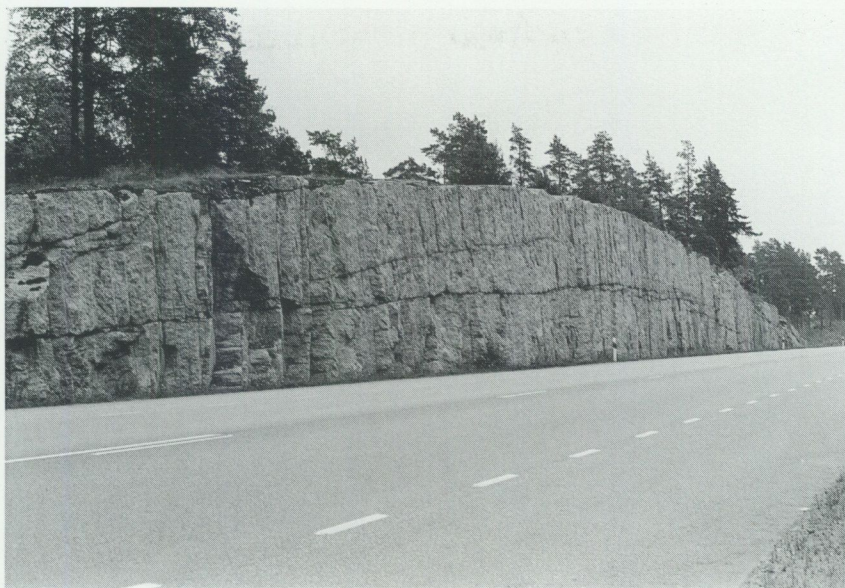
Fig. 16. Bankningssprickor i Karlshamnsgranit. E 22 vid Ronneby (6d). Sheeting in Karlshamn granite.
