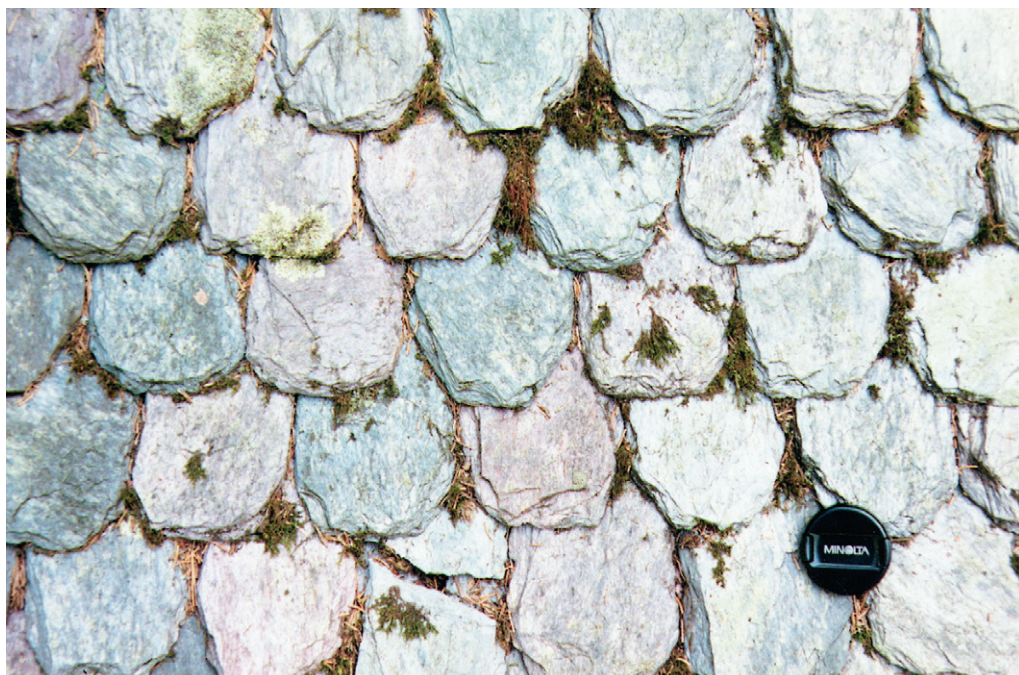
Fig. 72. Skiffertak på krutmagasin vid Hörnebo skiffergruva. 700 m ONO Hörnebo (9i) 634615/144240. Schist on a roof at the Hörnebo mine.
