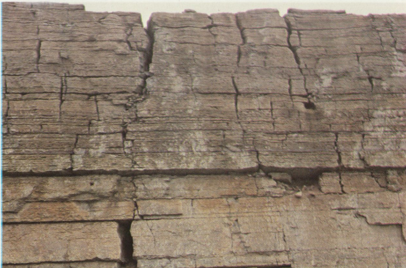
Sprickor i kalksten vidgade av karstvittring, vertikal bergyta. Degerhamn. Foto C-F. Müllern.
