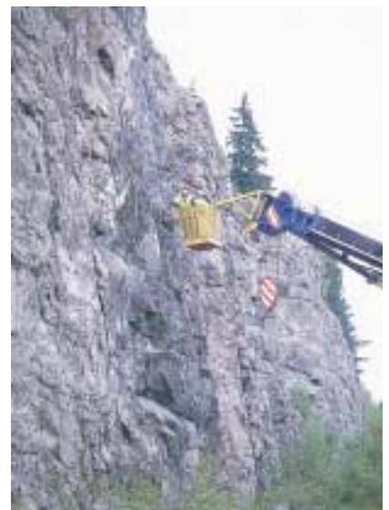
Skrotning, dvs. rensning av löst berg från bergvägg längs E4an norr om Södertälje. Foto: A. Damberg.
