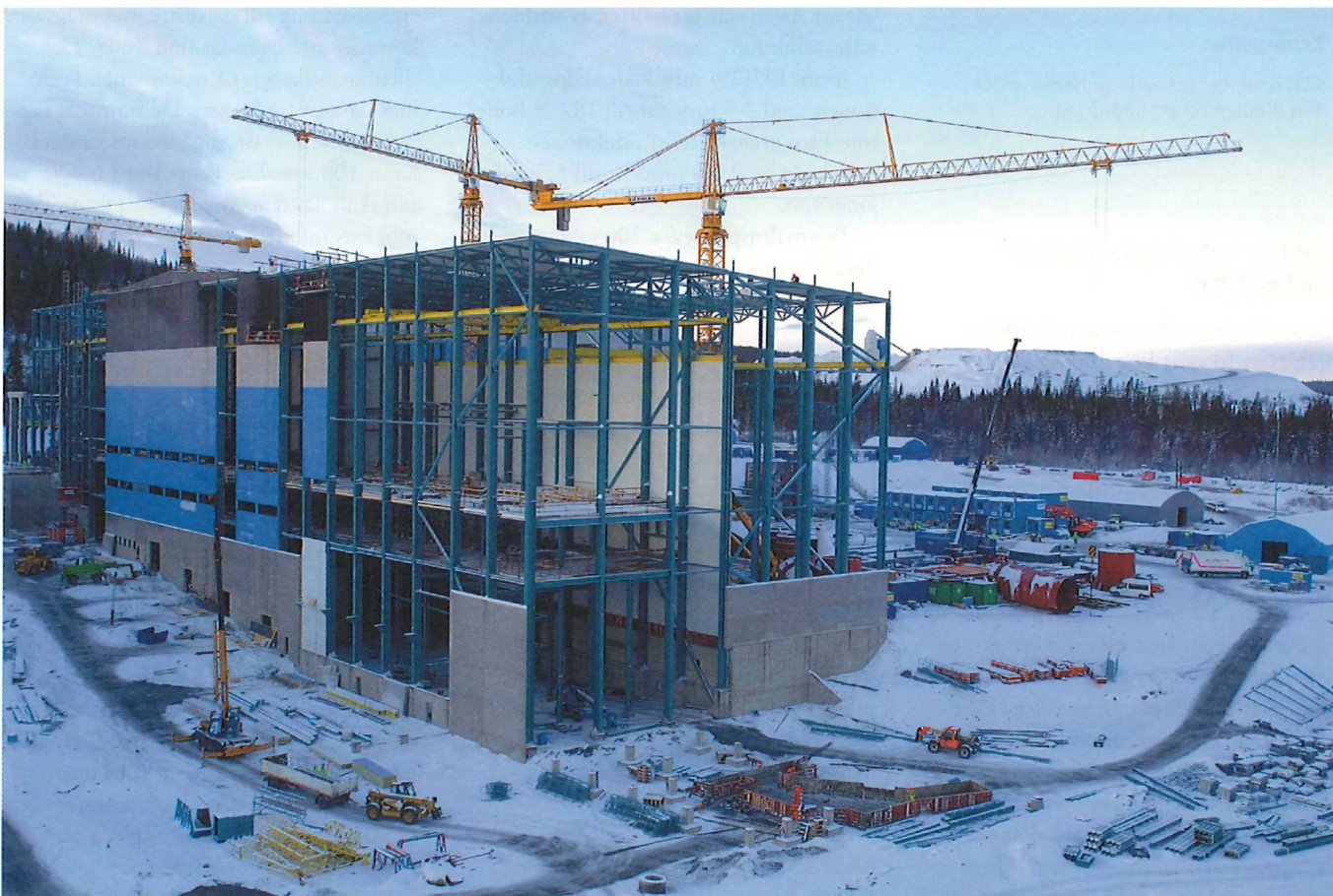
Ett nytt pelletsverk byggs i Malmberget. Det blir klart till hösten 2006. Foto LKAB.
