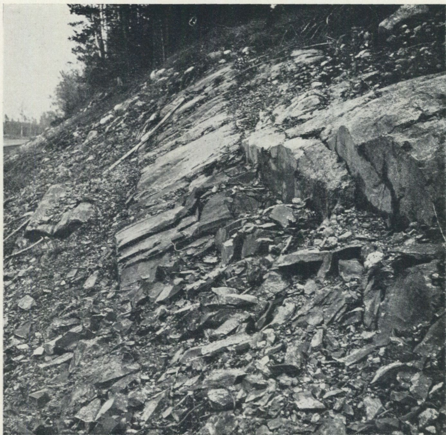
Bild 25. Diabasgång, som vid vägbreddning sprängts sönder i småskut till följd av tät förklyftning. Grindstugan, Husby-Rekarne socken, Södermanlands län. Foto P H Lundegårdh 1957.
