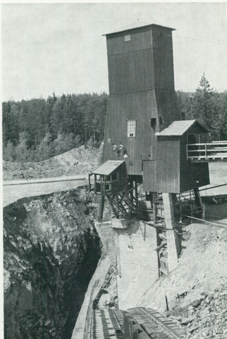
Abb. 1. Einsturz des mit Bergeversatz gefüllten, alten Tagbaues am 18.4.1962. Durch das Nachstürzen der Lockermassen wurde der südliche Teil des Schachtausbaues und die Verwerfung (schwarz, Bildzentrum) freigelegt. Bild gegen WSW aufgenommen.
