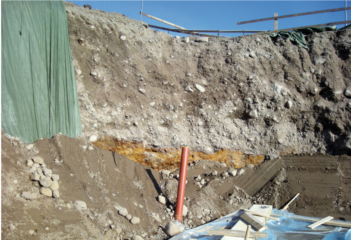
Fig. 12. Vid grundgrävningen för ett parkeringshus i Ullareds köpcentrum påträffades en komplex lagerföljd. Överst ca 3 m med grå, hårt packad sandig morän och därunder isälvsediment. Isälvsedimenten är missfärgade av bruna järnutfällningar. Foto: Tore Pässe.
