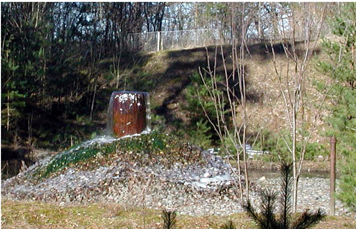
Fig. 13. I anslutning till Hallstahammars kommuns vattenverk vid Näs finns denna återinfiltrationsanläggning för att minska höga järn- och manganhalter i grundvattnet. Till höger i bild är ett observationsrör för mätning av grundvattennivå. Foto: H. Söderholm.
