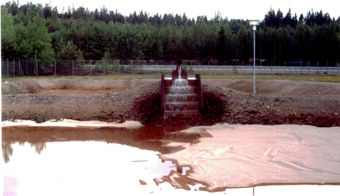
Fig. 44. Infiltrationsdamm med luftningstrappa. Luftningen medför att järn oxiderar som roströda utfällningar. Det översta lagret av sanden byts ut en gång per år. Observera närheten till landsvägen. Järnvägen är belägen omedelbart hitom vägen. Foto: Thomas Aneblom.
