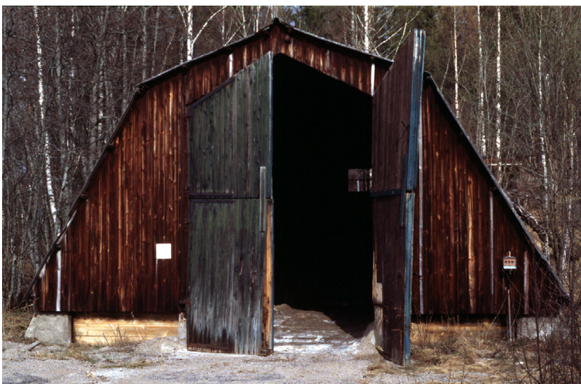
Fig. 15. Detta övergivna sand- och saltförråd finns utefter väg 250 norr om Kolsva. När bilden togs var ladan öppen och taket skadat varvid nederbörd lätt tränger in, vilket medför risk att salt lakas ut i grundvattnet i Köpingsåsen. Foto: H. Söderholm.
