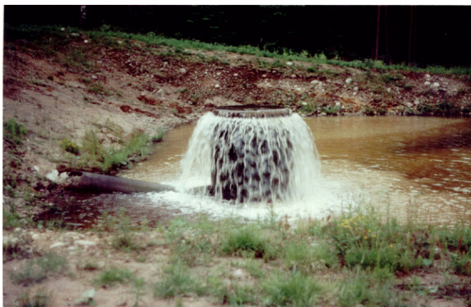
Fig. 14. Luftningsanläggning i infiltrationsdamm. Järnet oxideras vid kontakt med luftens syre och faller ut och bildar roströda avlagringar. Foto: Thomas Aneblom.
