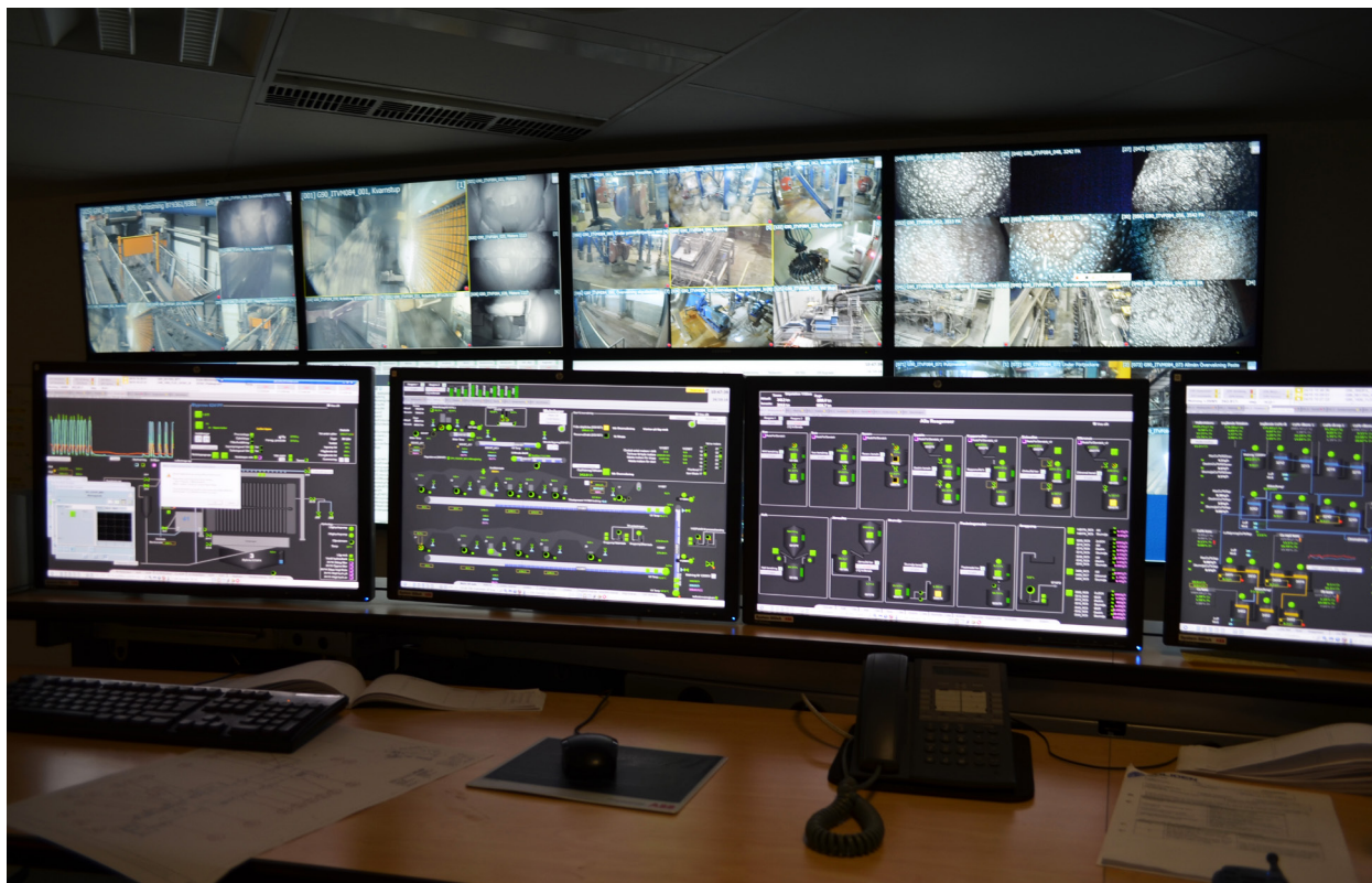
Kontrollrummet i Garpenberggruvan, en av Sveriges 13 gruvor med koncession och brytning. Foto: Peter Åkerhammar/SGU
