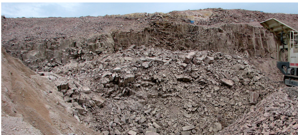
Fig. 10. Mycket av den uppspruckna porfyren kan grävas ur med maskin. Större fastare partier borras och sprängs.
