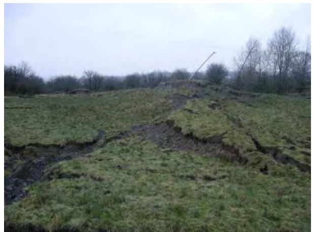
Figur 6. Bilden är tagen strax till höger om figur 5. Bilden visar den tidigare flacka överytan. Partiet har numera sjunkit ca 10 m och glidit ca 20–30 m i bildriktningen. Trots denna förflyttning är partiet relativt väl sammanhållet.
