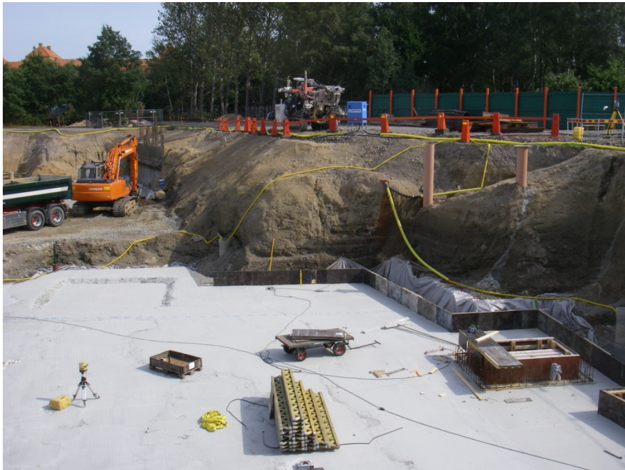
Figur 3. Översikt av schakten, foto från sydväst. I denna del av schakten är schaktslänterna i jurabergarter.
