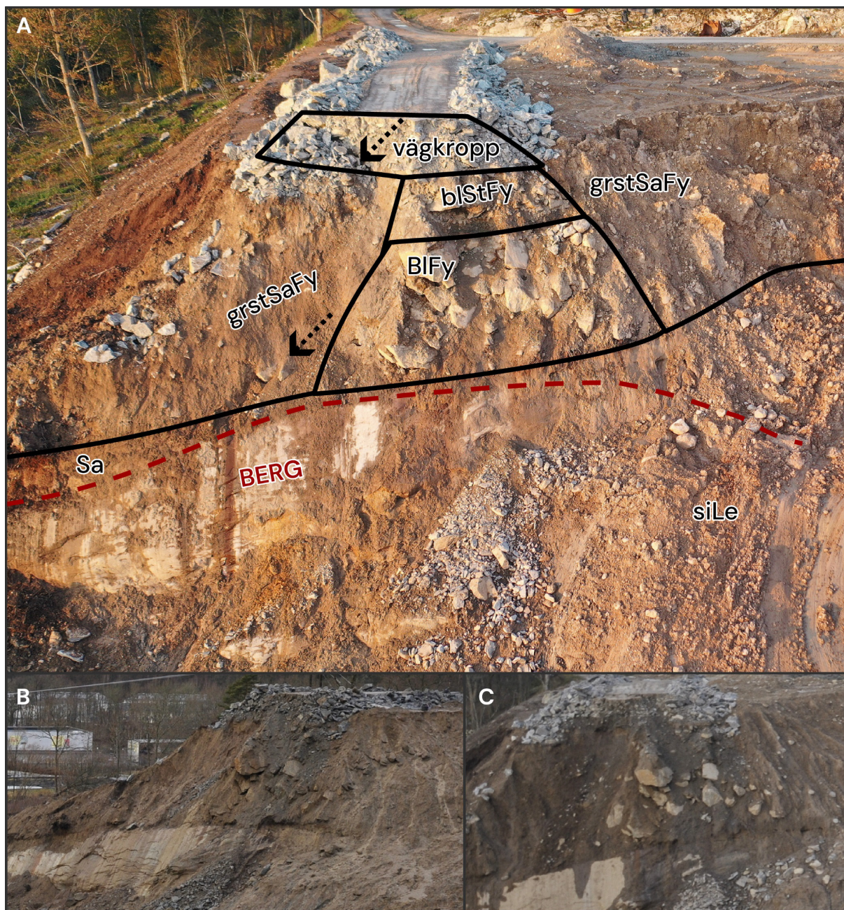
Figur 23. Skärningen genom vallen som skapades vid skredet visar hur vägkroppen ligger i förhållande till blocken i grunden. Svart linje från vänster till höger visar ungefärlig ursprunglig markyta, och streckad röd linje är berg. Blocken som utgjorde basen framträder tydligt och de något finkornigare massorna ovanpå och vägkroppen i ytan. Streckade svarta pilar visar material som flyttat på sig, men inte skredat iväg. (A) är fotat 2023-09-27, och (B)(C) är från 2023-12-21. I de nedre, senare fotona har jord spolats bort på grund av nederbörd, vilket gör avgränsningen till blocken än tydligare. Foto: Christian Öhrling.
