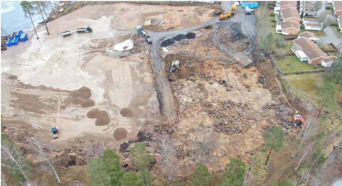
17 januari 2019. Återfyllnad pågår i norr och sanering i söder. Starkströmsledning syns med framgrävt gult band. Utsortering av block för återfyll.
